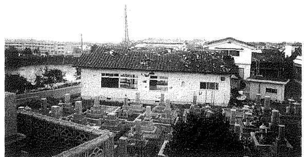
写真6 叶松自治会館における建物被害の状況(山口県小野田市叶松一丁目, 1999年9月27日, 山本晴彦撮影)
