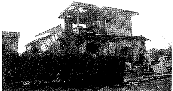
写真5 須田の木地区における家屋の全壊状況(山口県小野田市須田の木, 1999年9月30日, 山本晴彦撮影)
