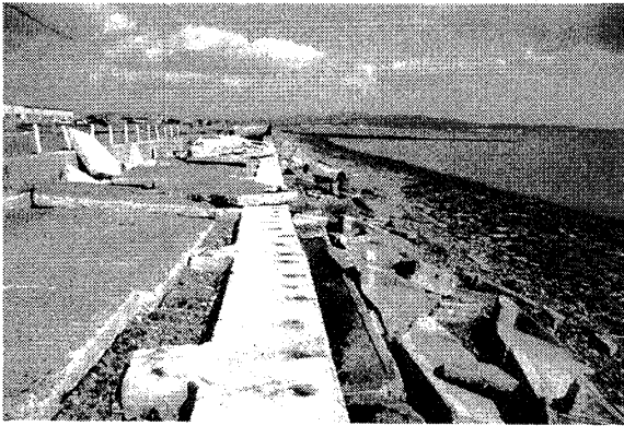
写真9 高潮により倒壊した防波堤の状況（山口県下関市長府扇町，1999年10月1日撮影）
