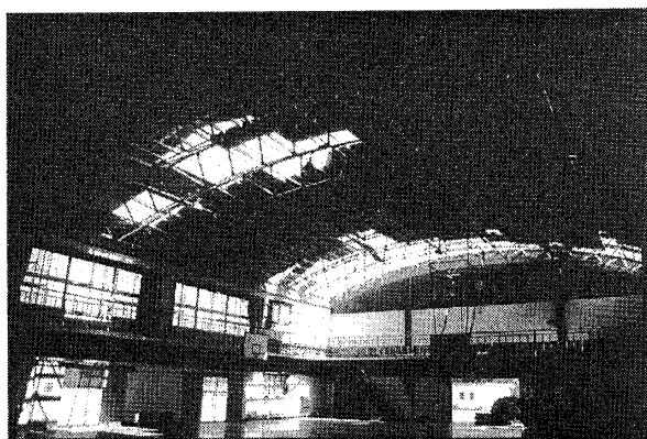
写真6 台風通過時の強風により損傷した宇部市立東岐波中学校における体育館の屋根の状況（山口県宇部市東岐波，1999年9月27日撮影）
