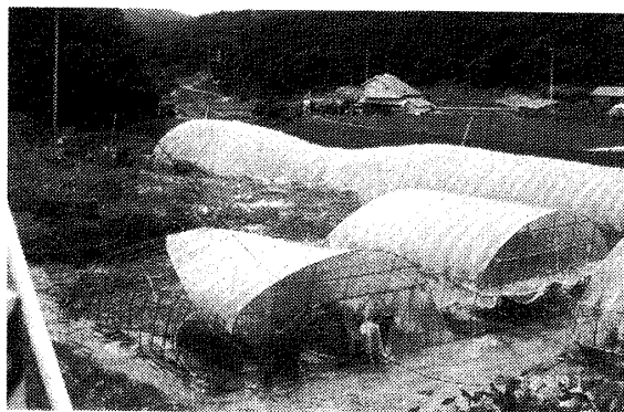
写真5 むつみ村特産のトマトの雨よけハウスの被害状況 (山口県阿武郡むつみ村片保中橋 1997年7月29日撮影, むつみ村提供)
