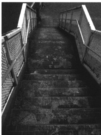
歩道橋の階段も古く、剥がれている。
