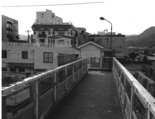
歩道橋の手すりが錆びついている。
