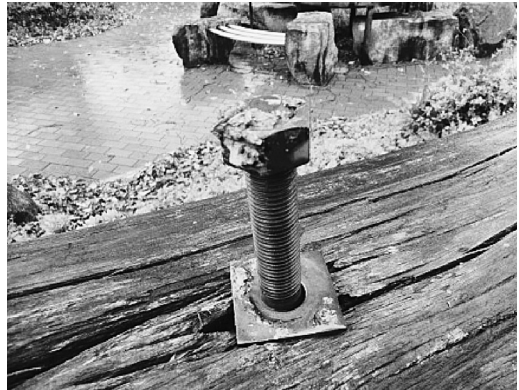
(図18) ボルトが飛び出ている危険
