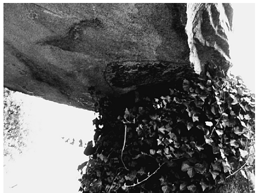
(図20) 蔦が生え、ひび割れている
