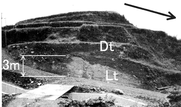
写真-1 油谷地域、道手地区の地すべり土塊中の第三紀層強風化砂岩泥岩互層(Lt)、上位は玄武岩質の礫混じり粘性土(Dt)。矢印は斜面傾斜方向。(図-6参照)
