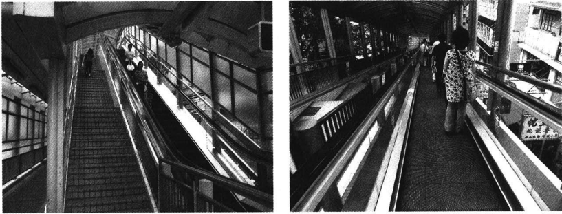
写真2-3-2 エスカレータ(左)と斜行型動く歩道(右)
