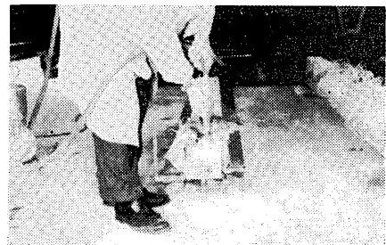
写真3 グラウトの状態
