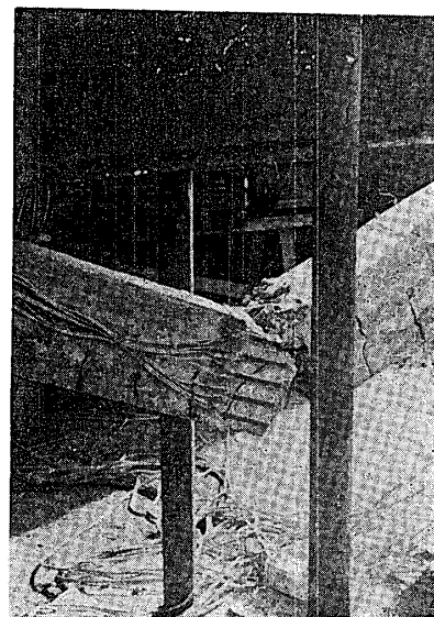
写真-2, b ハリ破壊後の状態
